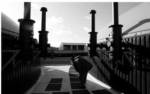
En cas de surpression à l'intérieur des dômes, le méthane s'échappe par des cheminées et est brûlé par des torchères.
